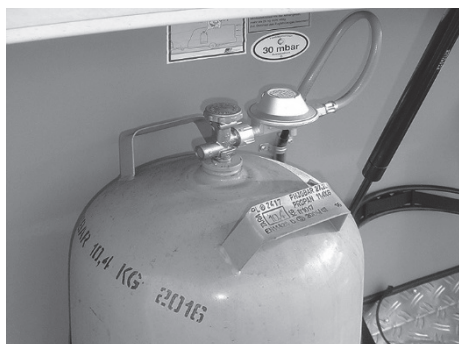
Fig. 115: Gasflaske med trykreduktionsventil
