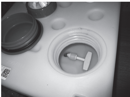
Fig. 104: Bundprop i drikkevandstanken
