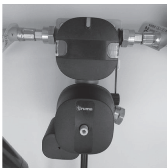
Fig. 76: Gasanlæg (med Eis-Ex og fjernvisning)
