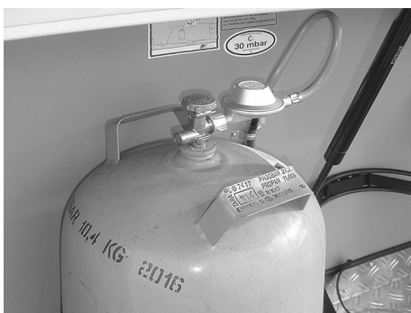
Afb. 83: gasfles met drukverminderingssklep
