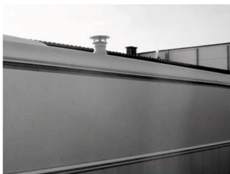
Afb. 77: Schoorsteen voor verbrandingsgassen van de gasverwarming
