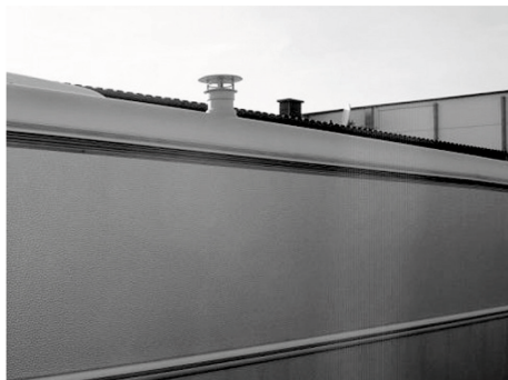
Afb. 95: Schoorsteen voor verbrandingsgassen van de gasverwarming
