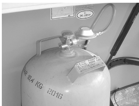
Bild 112: Gasolflaska med tryckreducerventil
