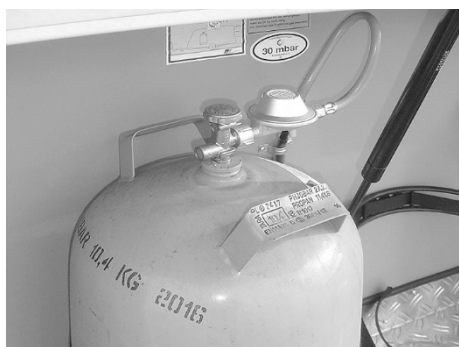
Bild 111: Gasolflaska med tryckreducerventil
