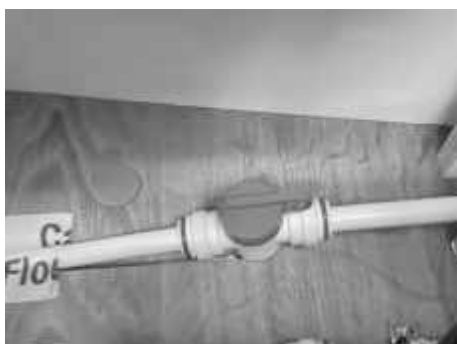
Bild 91: Ventil golvvärme ALDE
